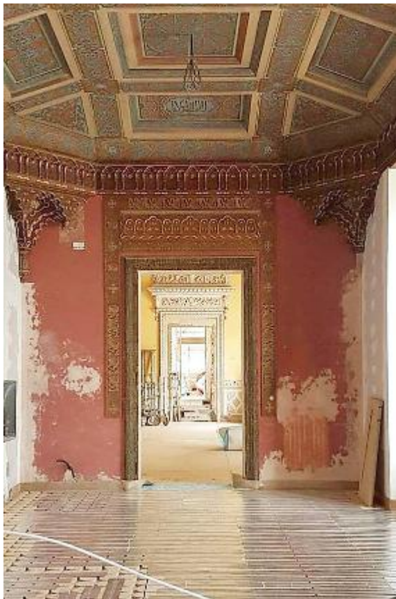
Una delle tante sale dell'edificio in allestimento dopo i danni del sisma 2012 (foto Cristiano Ferrari)
